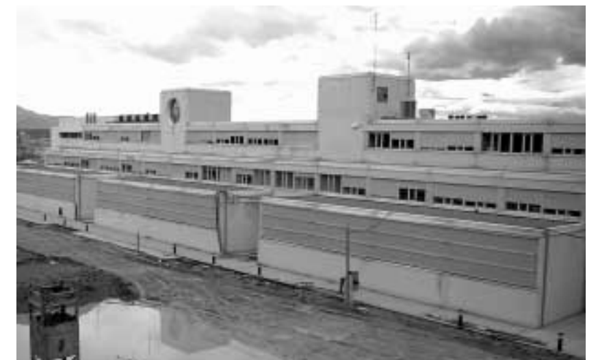
Pantalles acústiques instal·lades en l'edifici 2 de l'Escola Politècnica
