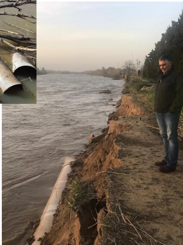
ITAM Tordera – Canonada captació
