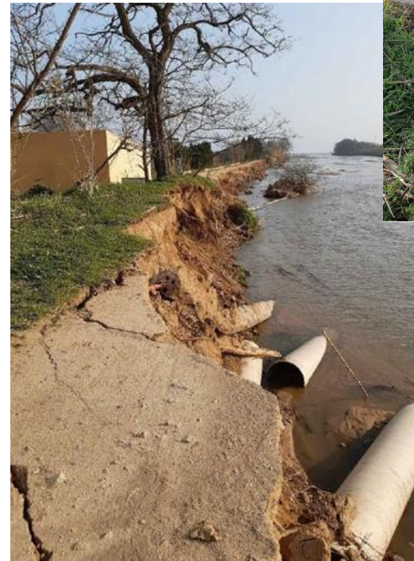
ITAM Tordera – Canonada captació
