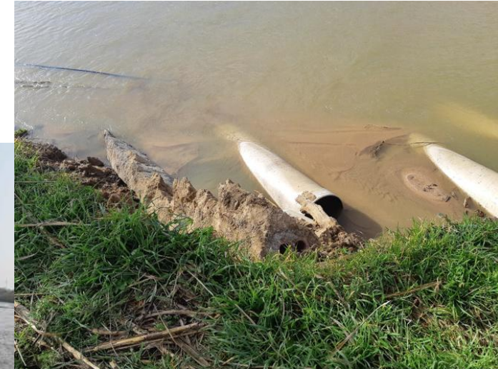
ITAM Tordera – Canonada captació
