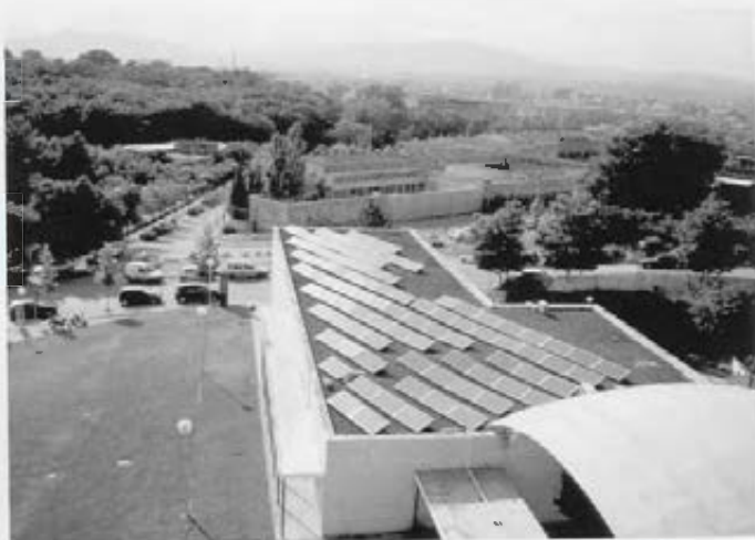
Detall de l'instal·lació fotovoltaica del projecte UNIVERSOL
